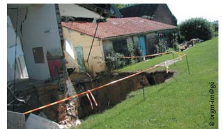
Effondrement de terrain, Somme.
